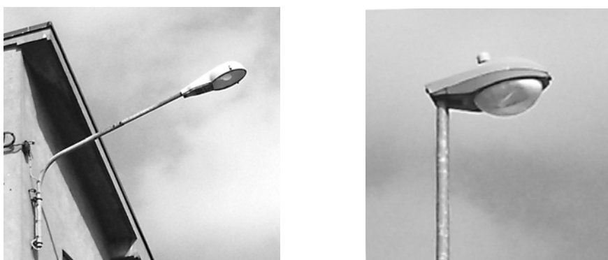
Figura 3-4: armatura con vetro di protezione assente in via Albericia (a sx) e armatura con vetro di protezione curvo in via Europa (a dx)
